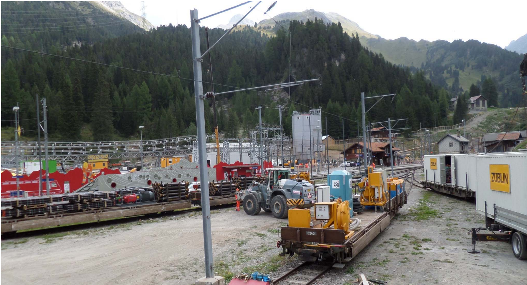
Reine Zugversorgung, BE Einrichtung
